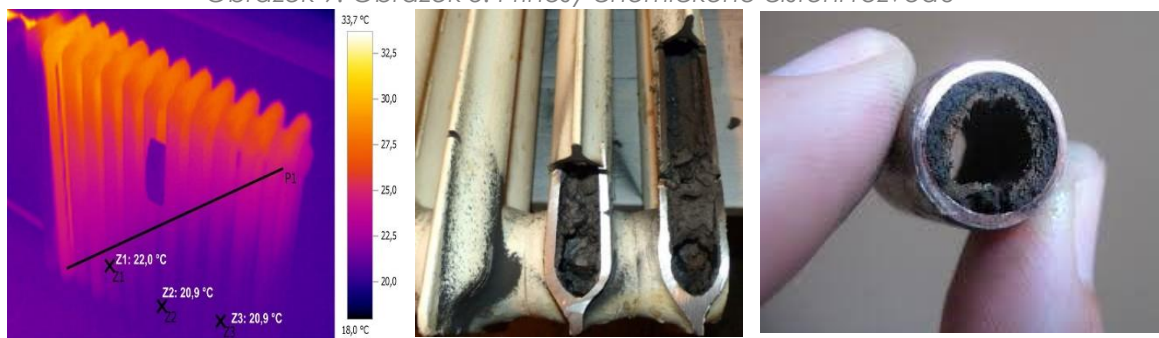
Obrázek 9: Obrázek 8: Přínosy chemického čištění rozvodů
