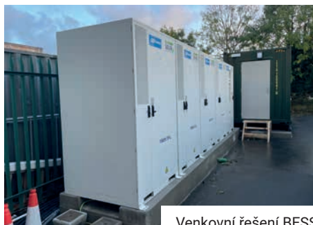
Venkovní řešení BESS
